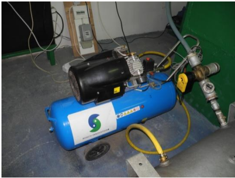
Abbildung 2 Kompressor mit Luftversorgungsschlauch
