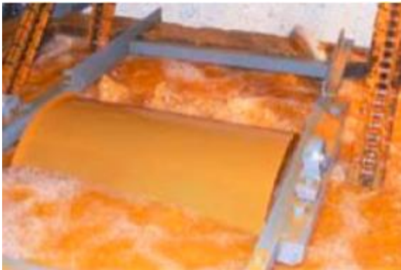
Abbildung 6 Offene Oberseite des Behälters im Betrieb
