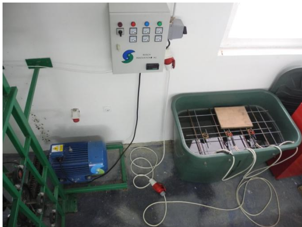
Abbildung 9 Generator mit Schaltschrank und Stromverbraucher
