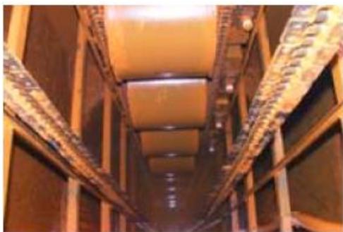
Abbildung 4 Innenansicht Auftriebsbehälter ohne Wasser
